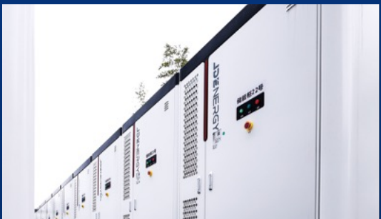
浙江锦盛控股集团11MW/22MWh储能项目 ——纺织+储能, 华东最大分布式模块化用户侧储能项目
