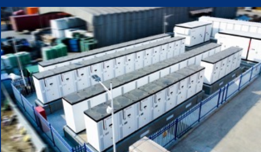
合肥TCL家用电器10MW/20MWh储能电站 ——为家电制造行业“智造之躯”注入绿色脉搏
