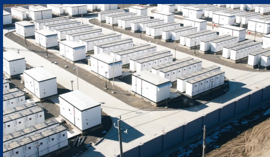
宁夏牛首山200MW/400MWh储能电站 ——全球最大的电网侧分布式模块化储能电站项目
