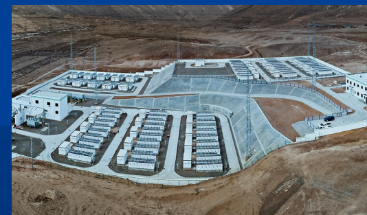
宁夏华严变200MW/400MWh储能电站 ——全球最大的电网侧分布式模块化储能电站项目
