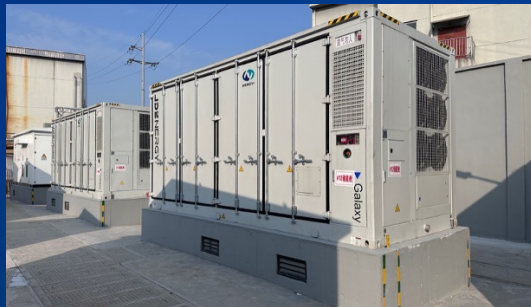
恒逸石化33.5MW/67MWh储能项目 ——奇点能源交付的浙江最大单体工商业储能项目
