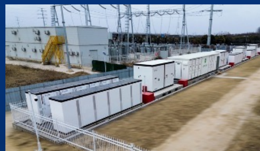
通威盐城10MW/20MWh储能项目 ——黄海之滨, 滩涂之上; 储蓄盐城无限风光
