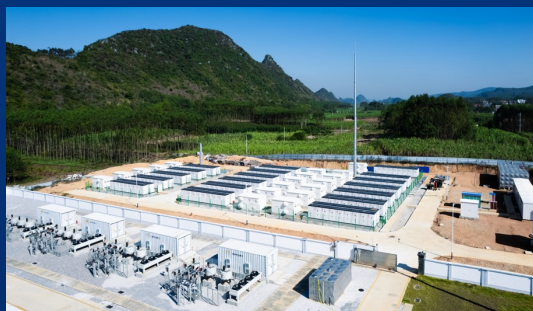
广西贵港144MW/288MWh储能电站 ——城市“能源绿肺” 保障西南地区能源稳定供应
