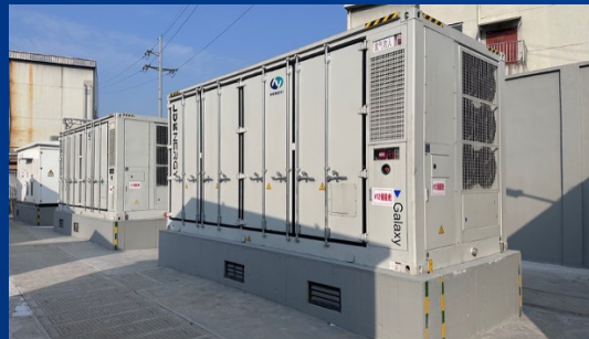
恒逸石化33.5MW/67MWh储能项目 ——奇点能源交付的浙江最大单体工商业储能项目
