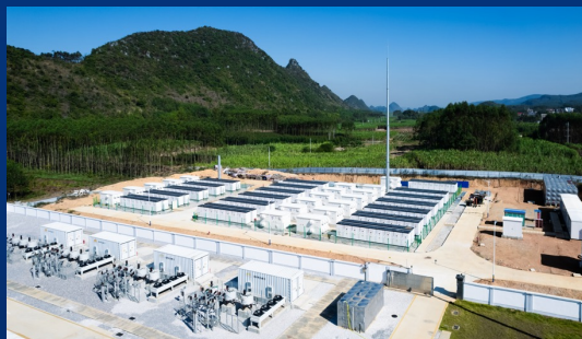
广西贵港144MW/288MWh储能电站 ——城市“能源绿肺” 保障西南地区能源稳定供应
