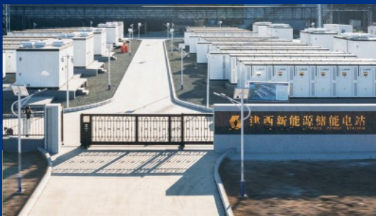
津西新能源60MW/120MWh用户侧储能项目 ——大国钢铁+储能 华北最大分布式模块化用户侧储能项目
