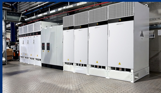
德国2MW/4MWh用户侧储能项目 ——奇点能源首个德国用户侧储能项目
