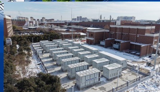
江苏淮安25MW/50MWh工商业储能项目 ——奇点能源交付的江苏最大单体工商业储能项目
