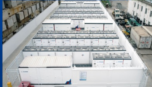
深圳赤湾16 MW/60 MWh储能示范项目 ——35天极速交付 广东省最大分布式模块化用户侧储能项目
