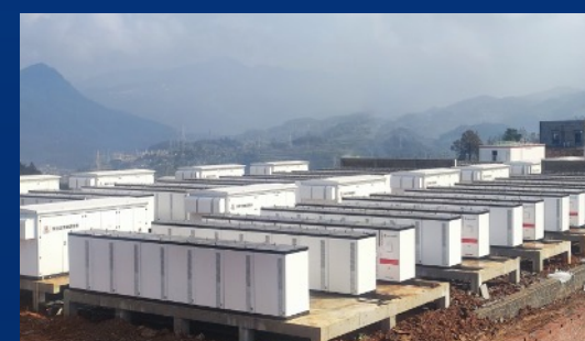
震东100MW/200MWh电化学储能项目 ——山颠克难 树立巴蜀储能项目标杆
