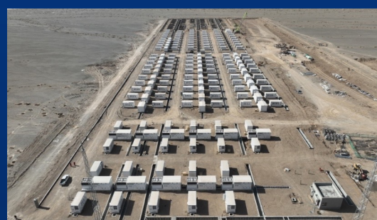
甘肃酒泉450MW/900MWh储能电站 ——打造源网荷储一体化示范储能项目
