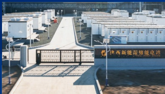
津西新能源60MW/120MWh用户侧储能项目 ——大国钢铁+储能 华北最大分布式模块化用户侧储能项目
