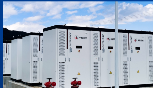
中核临翔200MW/400MWh储能电站 ——滇西群山中的“能量方舟”
