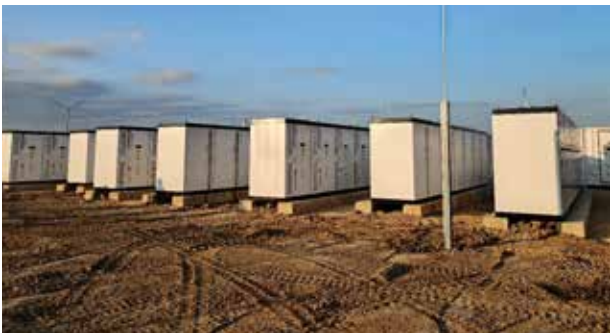
匈牙利MVM国家电网11MW/22MWh储能项目 ——奇点能源首个海外源网侧储能项目
