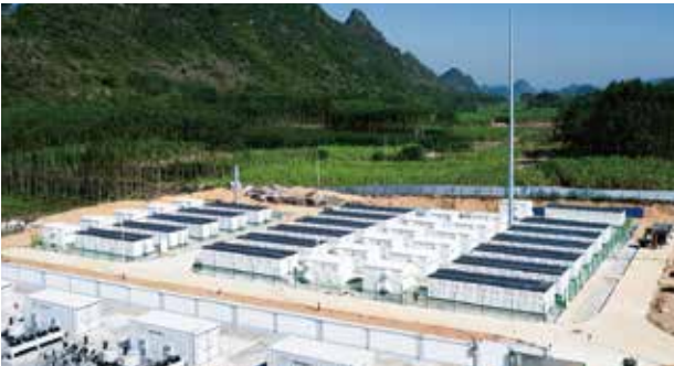
广西贵港144MW/288MWh储能电站 ——城市“能源绿肺”保障西南地区能源稳定供应
