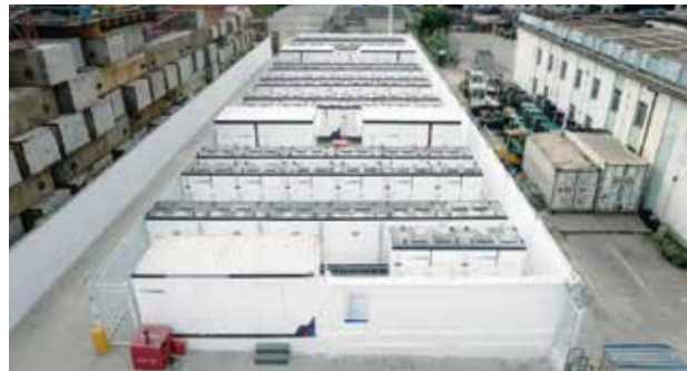
深圳赤湾16MW/60MWh储能示范项目 ——35天极速交付 广东省最大分布式模块化用户侧储能项目
