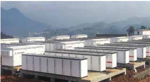
震东100MW/200MWh电化学储能项目 ——山巅克难 树立巴蜀储能项目标杆
