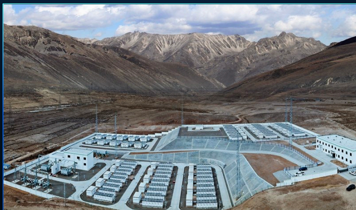
宁夏华严变200MW/400MWh储能电站 ——全球最大的电网侧分布式模块化储能电站项目
