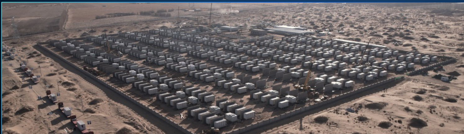
内蒙古磴口500MW/2000MWh储能项目 ——奇点能源交付的首个GWh级储能项目
