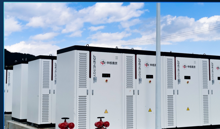
云南中核临翔200MW/400MWh储能电站项目 ——云岭大地稳定电网、赋能发展的巨型能量枢纽
